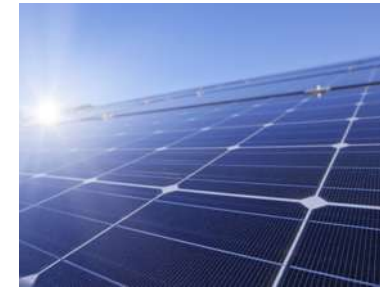
太陽光発電システム
